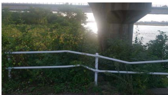
パトロール状況（ガードパイプの破損）
