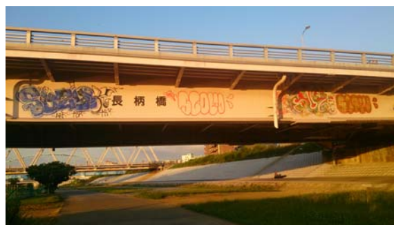
パトロール状況（橋脚の落書き）
