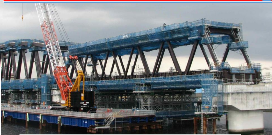
阪神電車なんば線淀川橋梁の高架工事 コンクリートの橋桁完成、上部のトラス工事中
